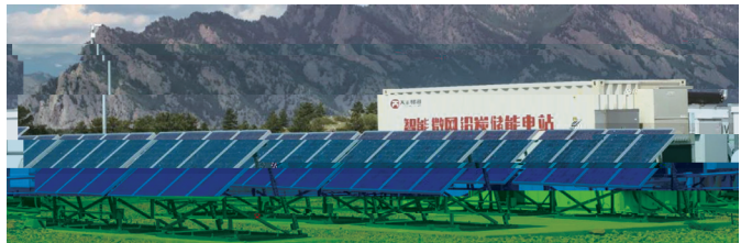
高性能鉛炭電池儲能項目
